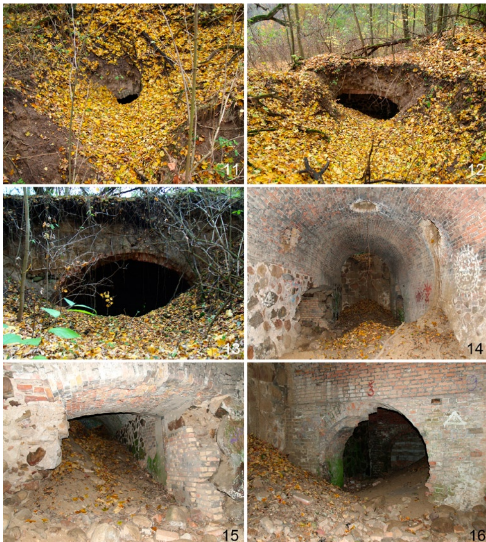
Ryc. 11-16. Zrujnowane fragmenty piwnic (fot. K. Kryza). Figs 11-16. Ruined fragments of cellars (photo by K. Kryza).
