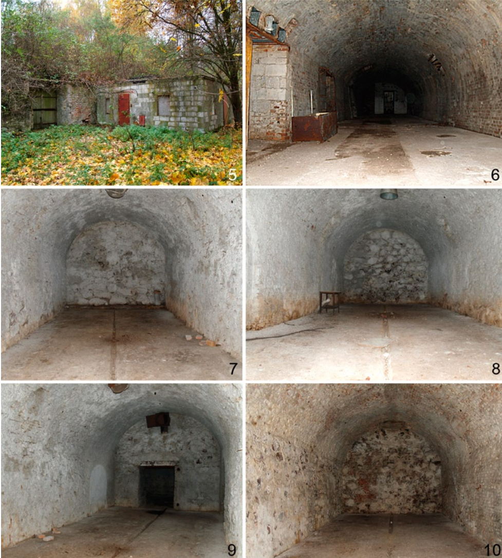
Ryc. 5-10. Elewacja zewnętrzna i wygląd wnętr lepiej zachowanego kompleksu piwnic: korytarz łączący (ryc. 6) i 4 piwnice (ryc. 7-10) (fot. K. Kryza).
