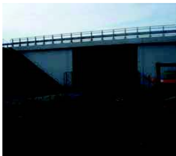
Fot. 4 Przykład przejścia dolnego. Zauważalny jest brak zieleni naprowadzającej oraz brak ekranu antyolśnieniowego. Fot. Grzegorz Gołębniak.
