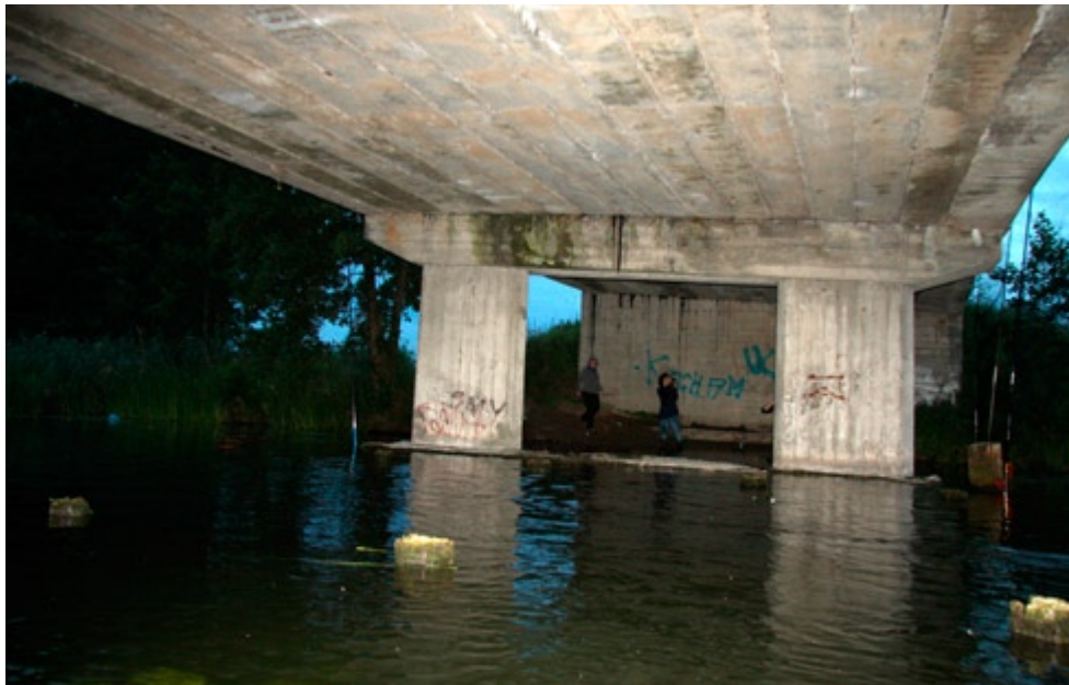
Fot. 1. Most na Czarnej Hańczy z widocznymi szczelinami, w których obserwowano nietoperze. Fot. A. Kmieciak.
